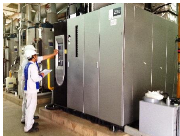
対象機器の貫流ボイラ
